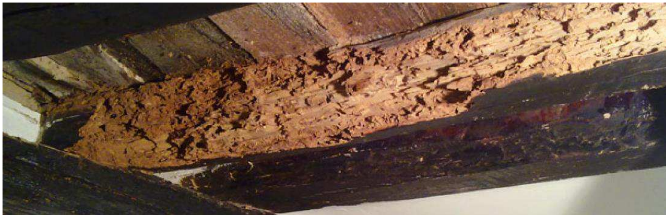
Ataque de las termitas en una viga
